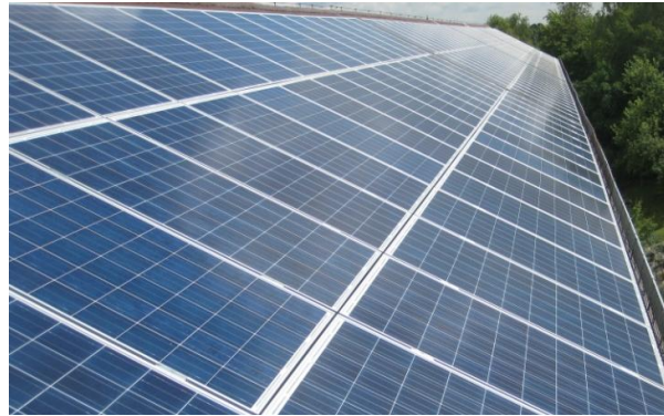
100 kWp PV-Kraftwerk auf der Grund- und Mittelschule Eching im Eigenverbrauch – Fertigstellung Mai 2013
