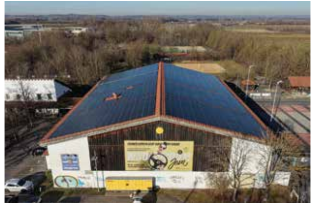
Bürger-Solardach TSV Neufahrn mit 269 kW installierter Leistung Foto: Michael Radeck
